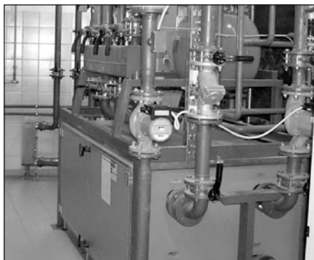
Slika 6. Srce energetskeg sastava – toplotna pumpa
