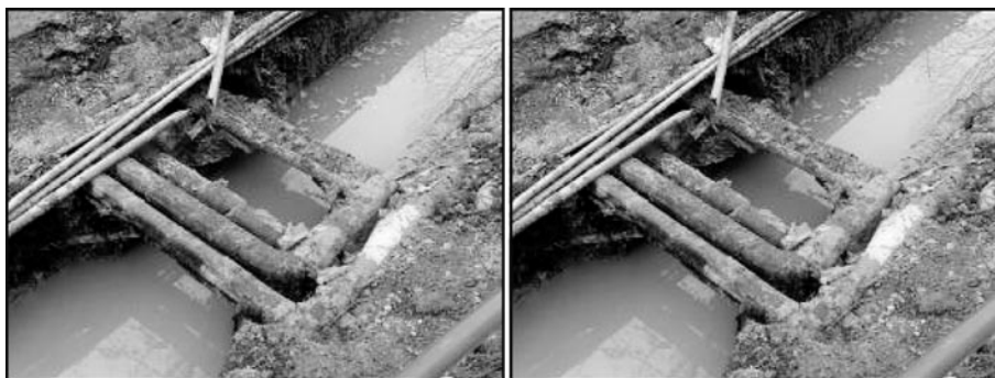
Slika 3. Propadanje čeličnih toplovoda usled korozije
